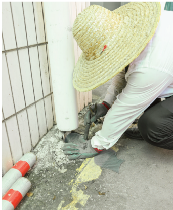
工作人员在广州中医药大学顺德医院为下水道加装防虫网。
