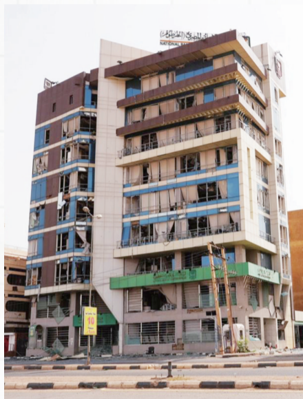
4月11日在苏丹首都喀土穆拍摄的受损建筑。 新华社发
