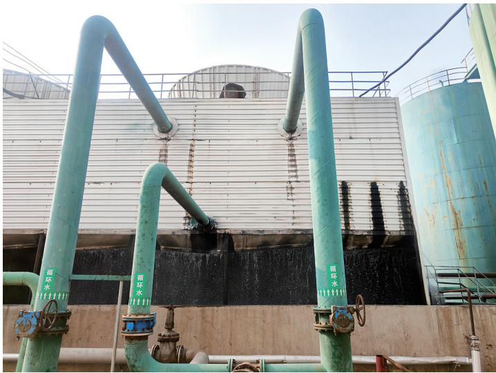
闭式循环冷却塔。 通讯员供图
