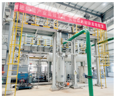
示范电站内部设备。
