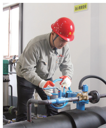
城区热力公司工作人员检查小区换热站设备。 通讯员供图
