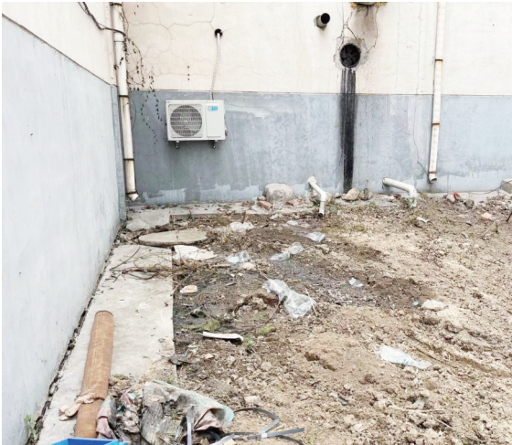
迎胜南路贤德苑小区存在化粪池外溢的情况，社区现将居民污水管道与沿街商户污水管道进行分离，有效解决了小区化粪池堵塞外溢情况。
