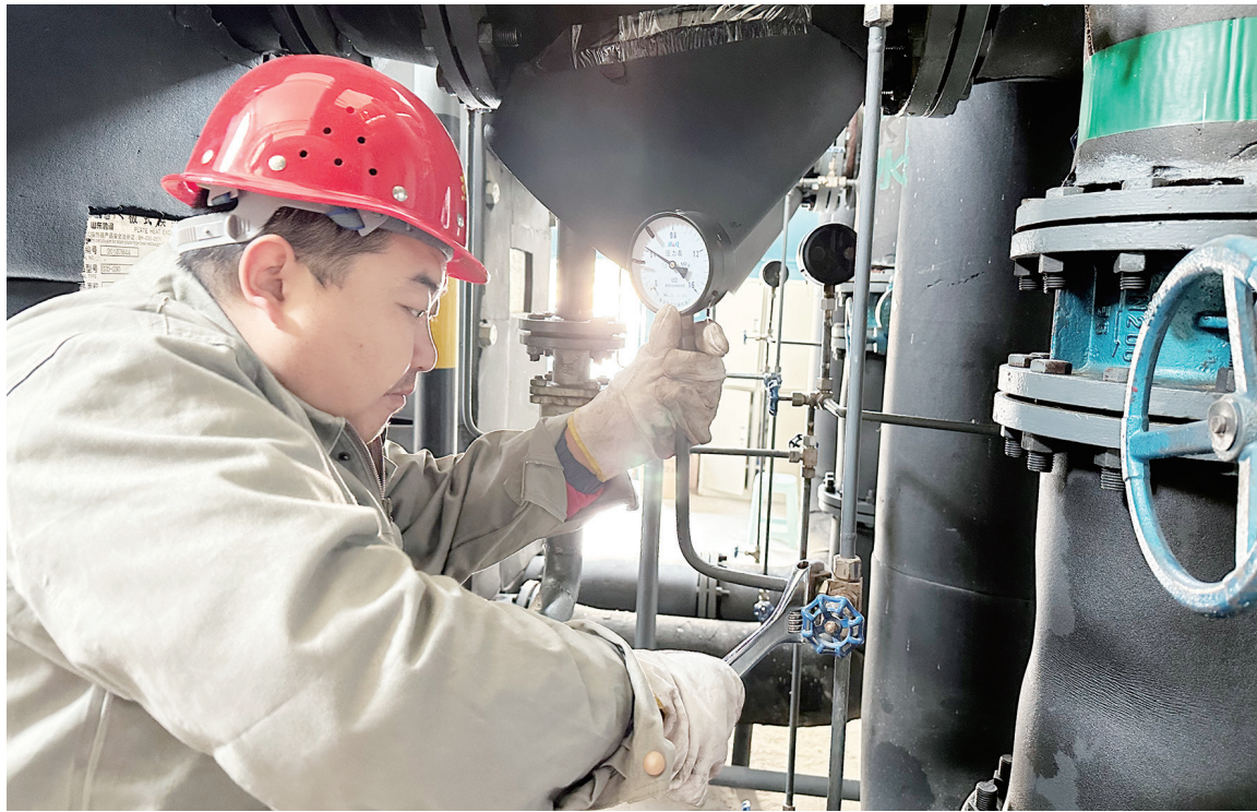
工作人员检查换热站设备。 通讯员供图
