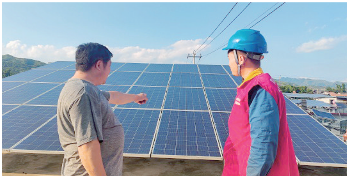
国网泰安供电公司工作人员现场检查光伏设备。 通讯员供图
