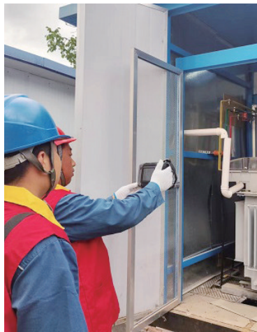
供电公司工作人员对用电设备进行测温。 通讯员供图
