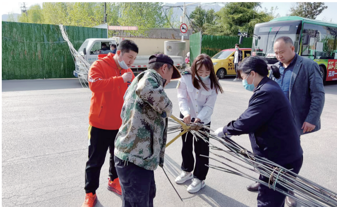
运营商配合交警、驾乘人员及邻近工地工作人员对线缆进行现场处置。 通讯员供图
