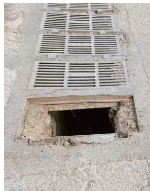
破损雨篦子修补前。
