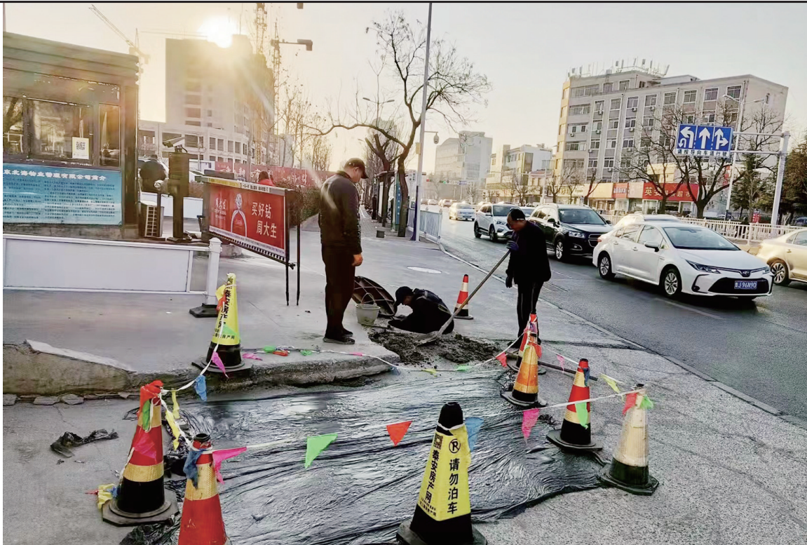
工作人员快速反应处理塌陷路面。 最泰安全媒体记者 董文一 摄
