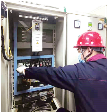
工作人员检查供热设备。 通讯员供图
