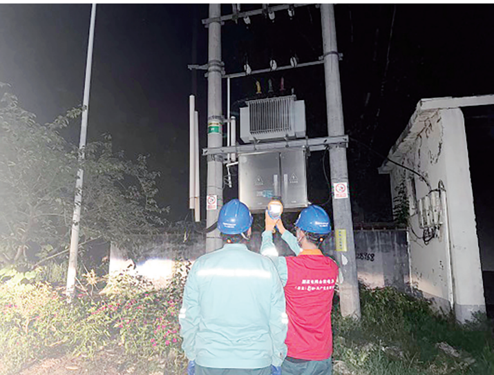
■工作人员用红外测温仪器对供电设备进行测温。 通讯员供图
