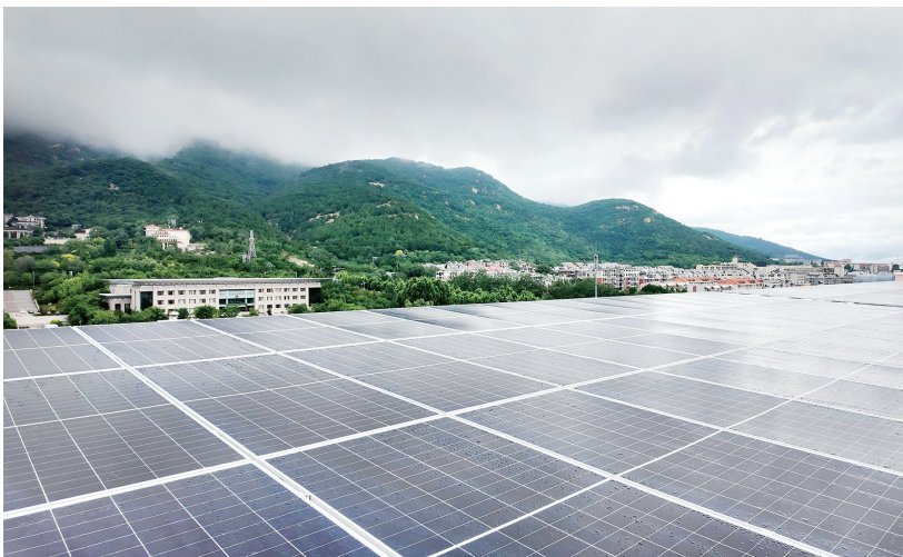
■市政中心屋顶铺设光伏板,源源不断生产绿电,支撑机关稳定运行。 记者 陈阳 摄
