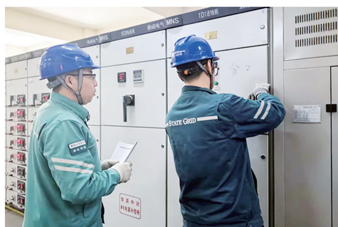
工作人员检查企业配电箱。
