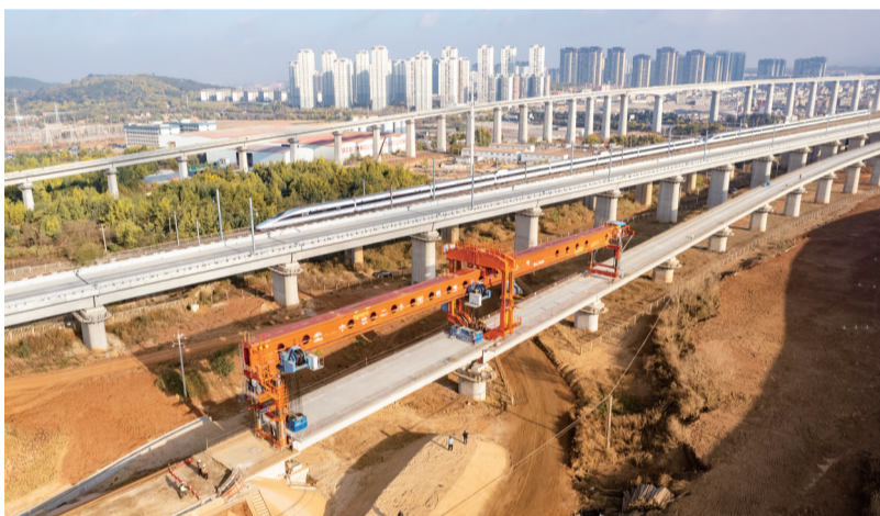
这是2月3日拍摄的渝昆高铁最后一榀箱梁架设施工现场(无人机照片)。2月3日上午,在位于云南省昆明市呈贡区的渝昆高铁施工现场,随着最后一榀箱梁精准落位,渝昆高铁全线桥梁建设全部完成,为后续铺轨及站后工程施工奠定了坚实基础,标志着渝昆高铁建设进入全面冲刺阶段。 新华社发
