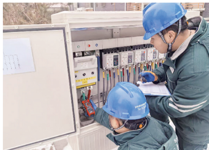
工作人员对供电设备进行测温。 通讯员供图
