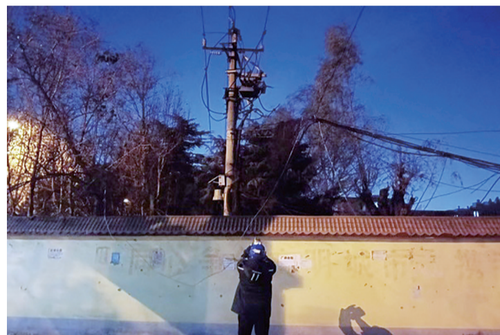
工作人员对供电设备进行测温。
