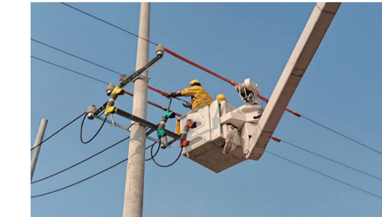
近日,国网泰安供电公司顺利完成10千伏刘家庄线等4处带电接火任务,为迎峰度冬和保暖保供筑起坚实防线。 记者 温雯/文 通讯员供图
