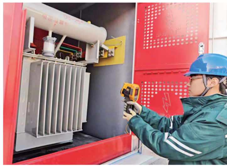
工作人员对设备进行测温。
