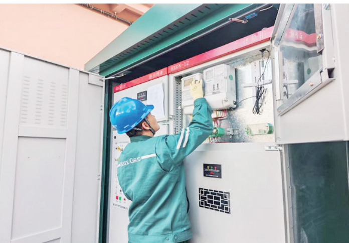
■巡检人员排查设备隐患。
