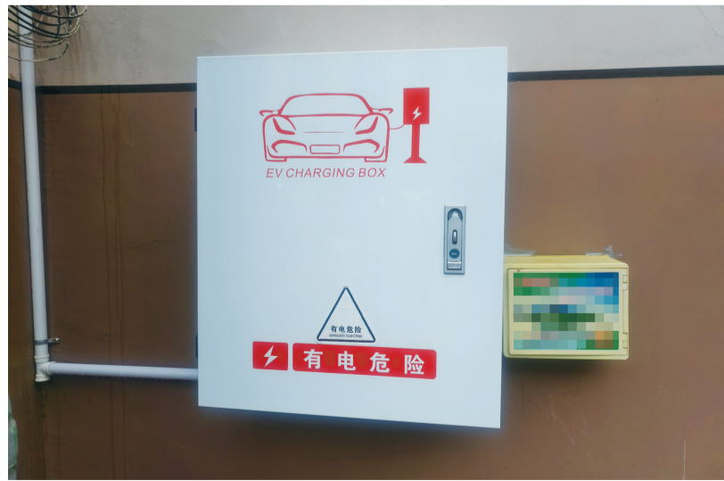
■居民家中安装的充电桩。 记者 李皓若 摄
