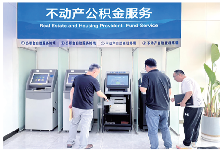
技术人员检查设备运行情况。 通讯员供图
