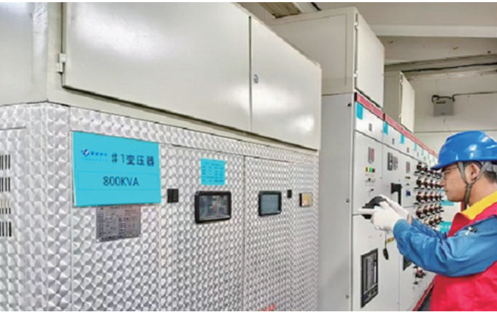
■工作人员开展安全用电检查。
