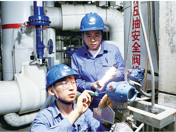
■设备维护人员检查压力变送器。
