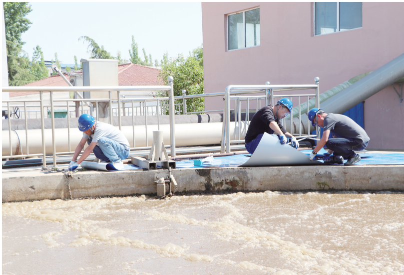
■一期氧化沟覆盖遮光板。
