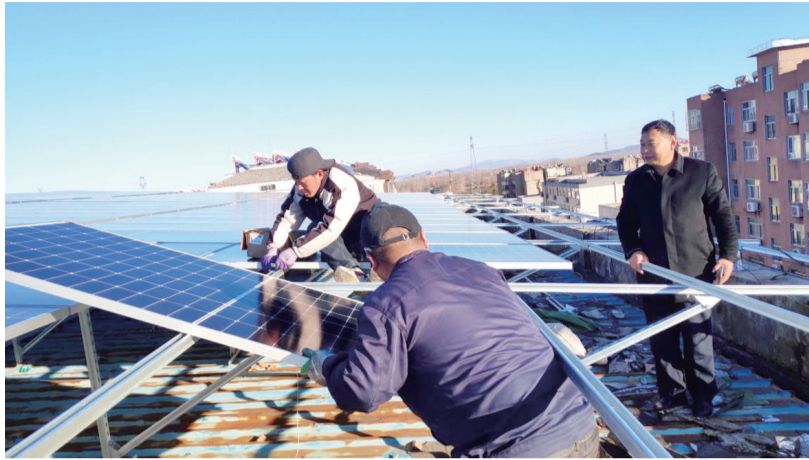
■羊楼西村光伏发电项目。 通讯员供图
