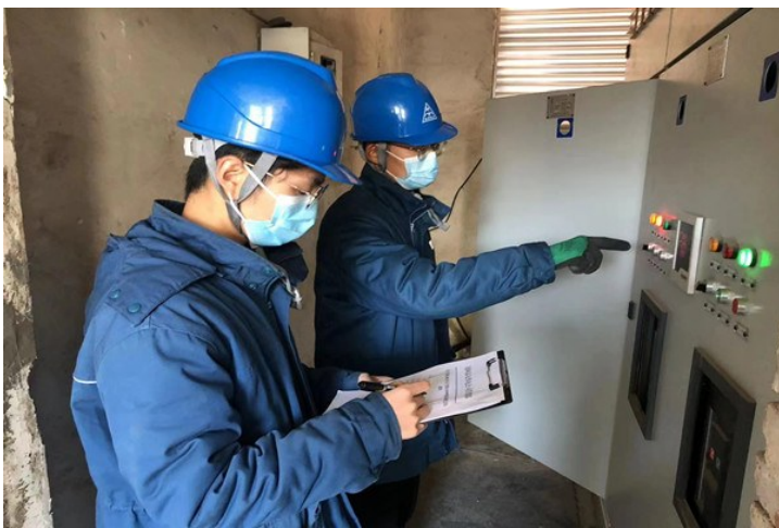
■工作人员对供电设备进行细致检查。
