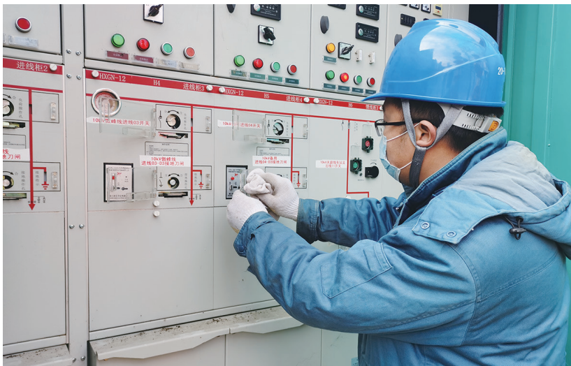
■工作人员检查供电设备。
