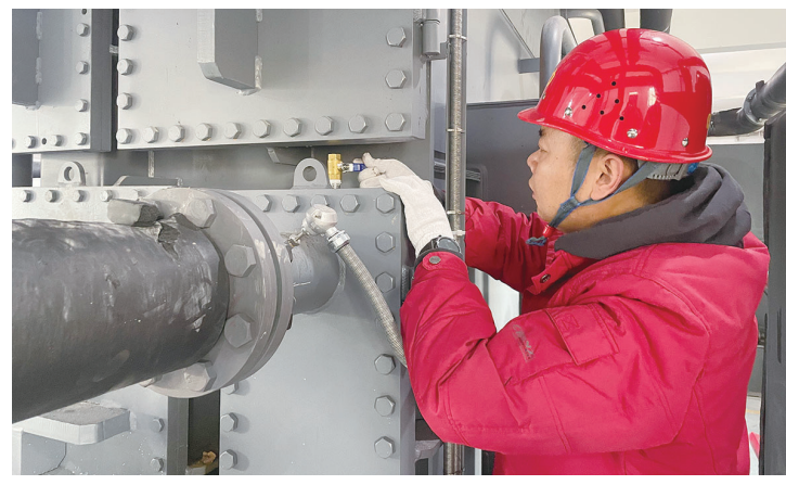
■工作人员正在巡检供热管道。 通讯员供图
